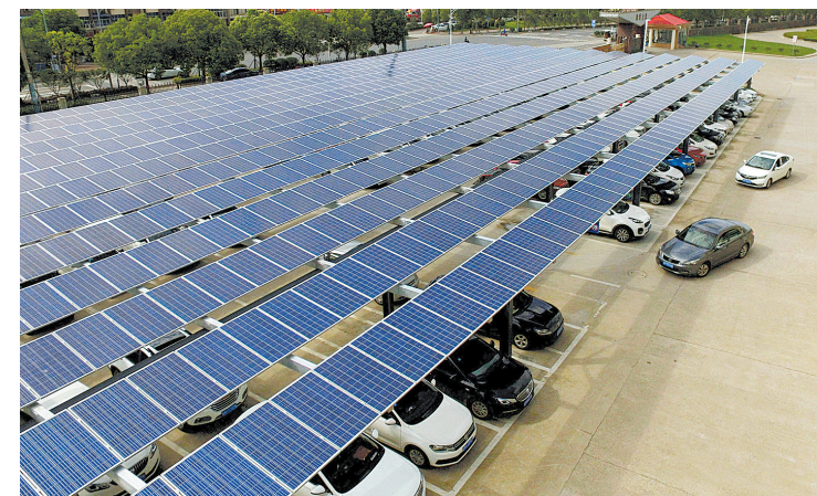
光伏发电停车场亮相安徽全椒
