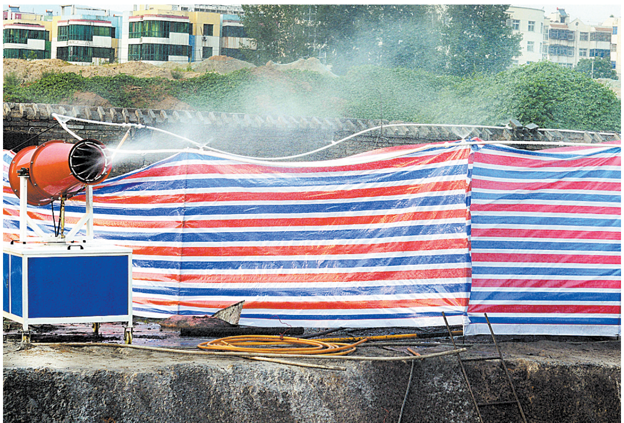
6月25日,淇河综合治理工程新建淇北干管工地开启移动雾炮、围挡喷淋装置进行水雾抑尘作业。为做好大气污染防治工作,淇河综合治理工程新建淇北干管项目建设单位在施工过程中同步开启移动雾炮、围挡喷淋装置进行水雾抑尘作业。本报记者 王尧 摄
