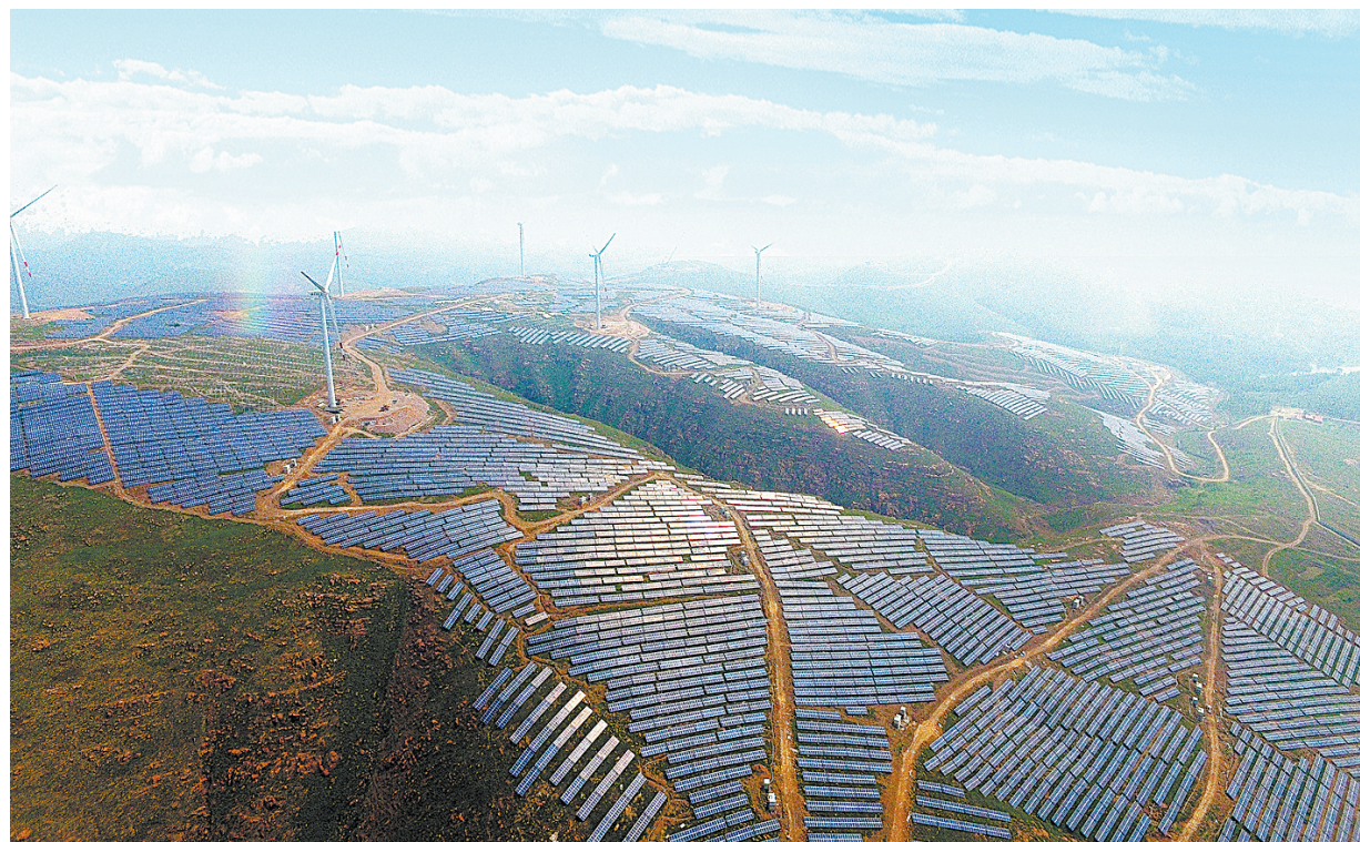
5月14日,太阳能光伏板在马头山上熠熠生辉。
