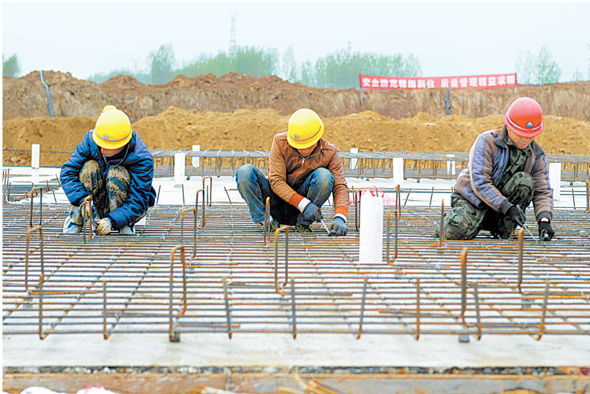
4月16日,施工人员在湛河治理工程许南路碾压坝项目工地固定底板钢筋。许南路碾压坝项目位于高新区遭化店镇韩庄村附近,是湛河下游河道治理的重要节点工程,技术含量高、施工难度大。为保证进度,建设单位增派机械人员昼夜施工,争取5月中旬前完成河道内全部土建工程。本报记者 王尧 摄
