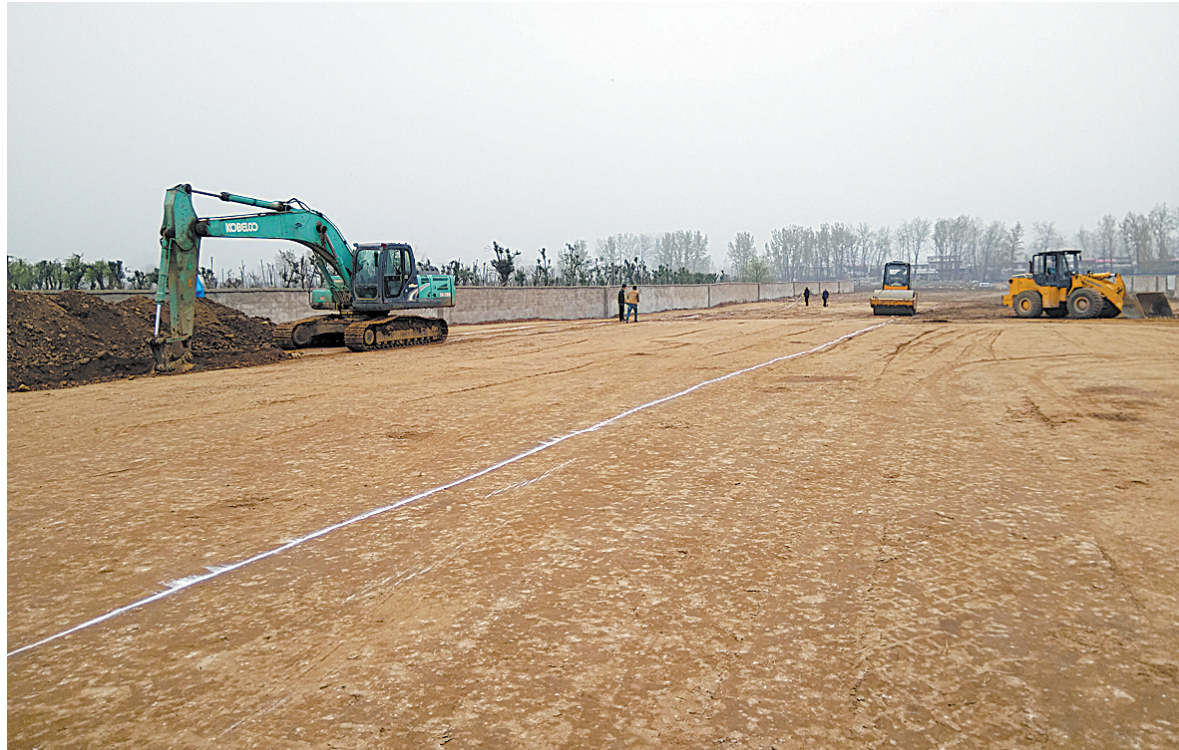
4月5日上午,鲁山县墨公路南延施工现场,工人们加紧施工。据悉,该路段是城南新区路网建设的重要路段,目前,路基已整平,正在开挖沟槽进行管网施工。
