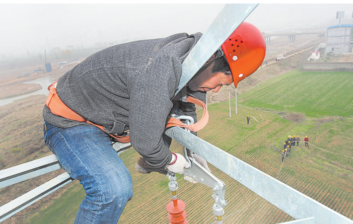
近日,施工人员对35千伏都堂线进行迁改。 据悉,35千伏都堂线部分线路处于郟万高铁标段规划的红线范围内,需对电力线路进行迁移。郟县供电公司主动联系地方政府,积极与工程指挥部沟通协调,组织技术人员进行现场勘察,重新规划电网布局,线路走向,制定最佳迁改建设方案。施工人员加班加点,连续奋战4基,新建铁塔11基,铺设电缆400余米,为重点项目建设“让道”。 本报记者 温书功 摄
