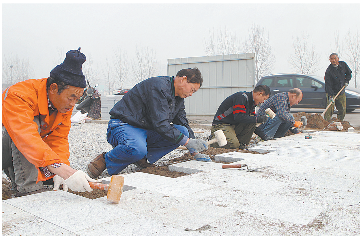
12月19日，施工人员在宝丰县为民路北延工程施工现场铺设人行道地砖。为北路是宝丰县城西部一条重要的南北通道，为北路北延工程全长840米，路宽40米，现道路已经全线贯通，基本具备通车条件，施工人员正在进行人行道道砖铺设、路灯架设等配套设施施工，预计年底可全部完工。
