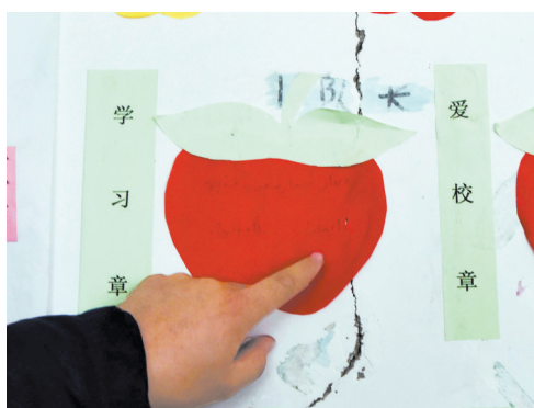
新疆呼图壁县石梯子乡小学出现墙体裂缝(12月8日摄)。
