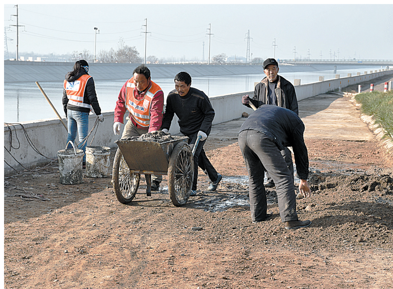
12月6日,施工人员在南水北调工程南水北调工程安全隐患,都县南水北调办南水北调工程安全隐患,对南水北调工程安全隐患进行全方位排查,并对排查出的安全隐患维修加固。本报记者 温书功 摄
