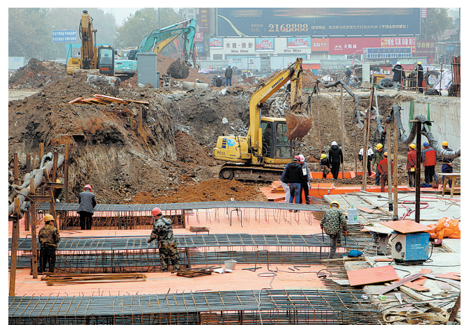
11月20日,工人在中兴路区域市政工程施工一期工程项目工地加紧施工。该项目建筑面积65837.44平方米,工程造价6亿元。
