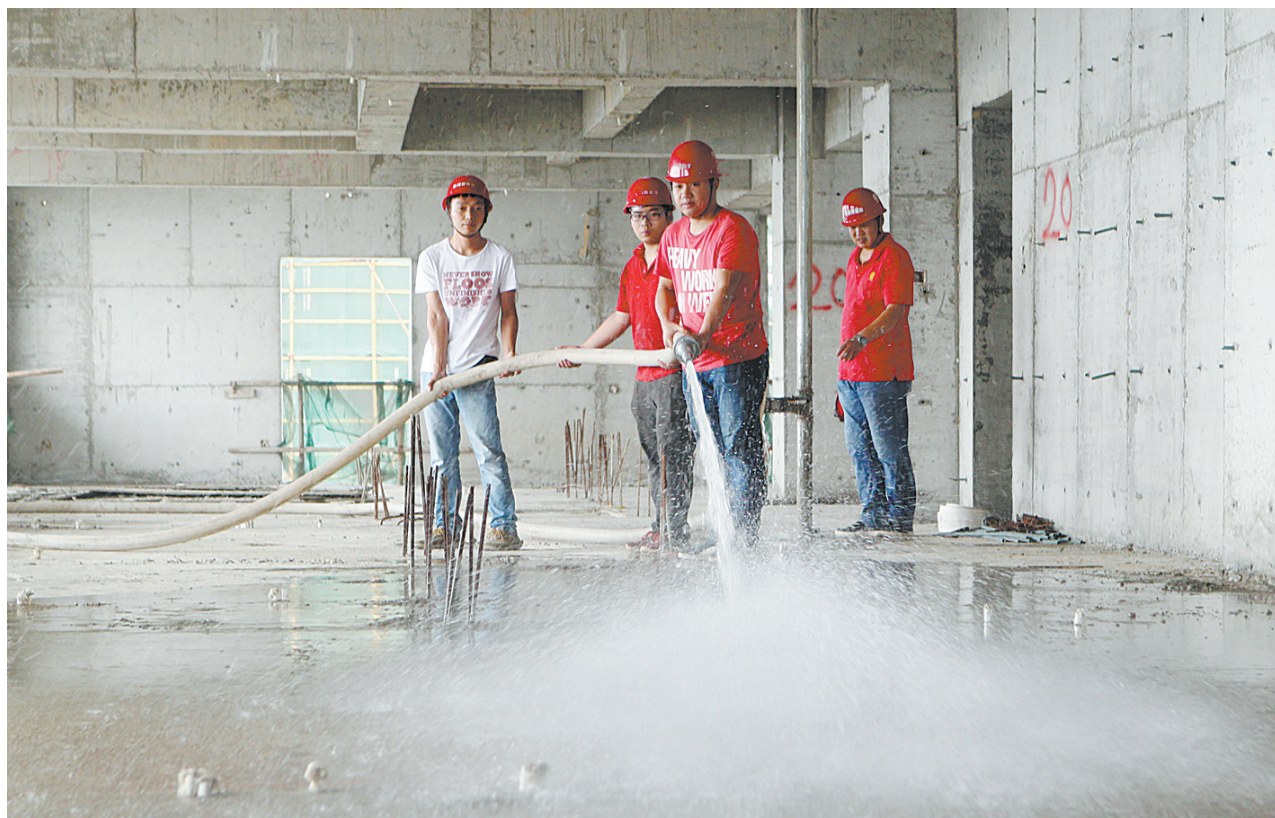
8月23日,建设路中段一处在建楼盘的施工人员用高压水枪冲洗楼层。为避免楼内灰尘随风飘散造成空气污染,施工方组织员工自本月下旬开始对已建成的楼层进行清扫、冲洗。 本报记者 姜涛 摄
