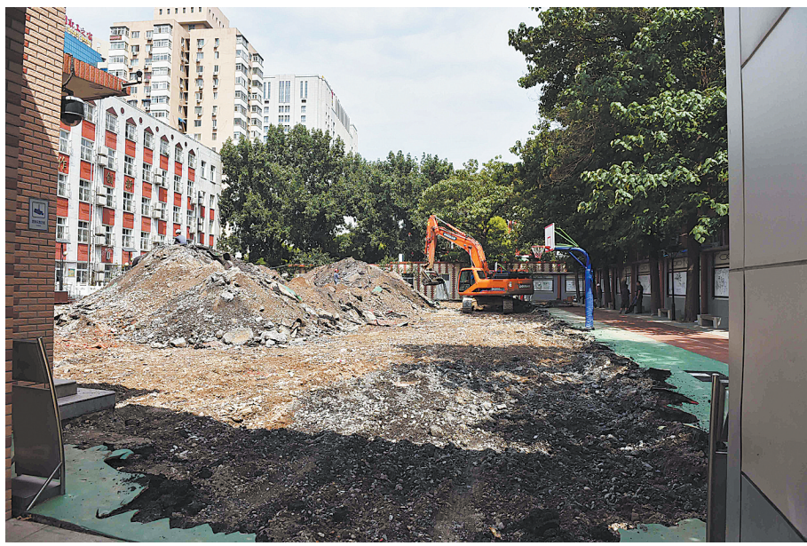
6月17日,挖掘机在实验二小白云路分校拆除操场(资料图片)。此前,北京市部分学校因翻修或新建塑胶操场和跑道出现异味,引起学生身体不适的情况。其中实验二小白云路分校操场经过环保部门的检测,塑胶操场检测样本各项指标均符合国家标准,但操场异味仍然存在。
