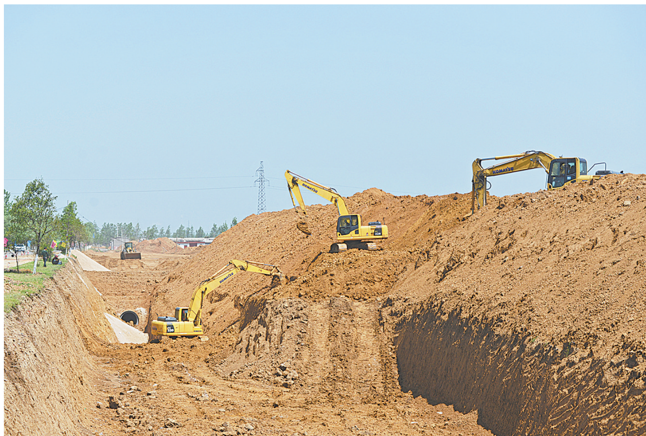
修水利 保灌溉 4月18日上午，施工人员操作着大型机械在叶县任店镇抗旱应急引水工程施工标段施工。 去年底开始，该县组织施工人员利用农闲季节，沿平桐路修建一条长约7.8千米的应急引水灌溉渠，以确保夏季乡、任店镇、城关乡等地麦田早涝保收。目前，该工程已基本进入收尾阶段。 本报记者 牛智广 摄
