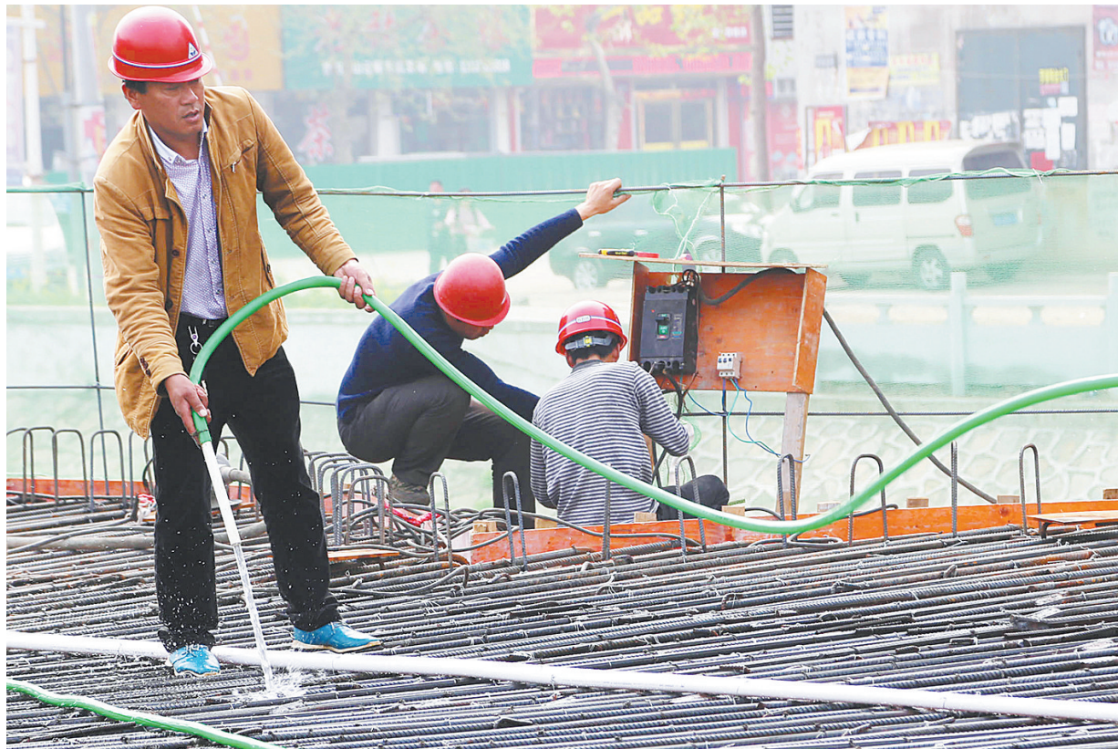
4月17日,工人在十环五环步行桥施工现场养护钢筋混凝土、铺设穿线管。今年,宝丰县投资1100万元对玉
