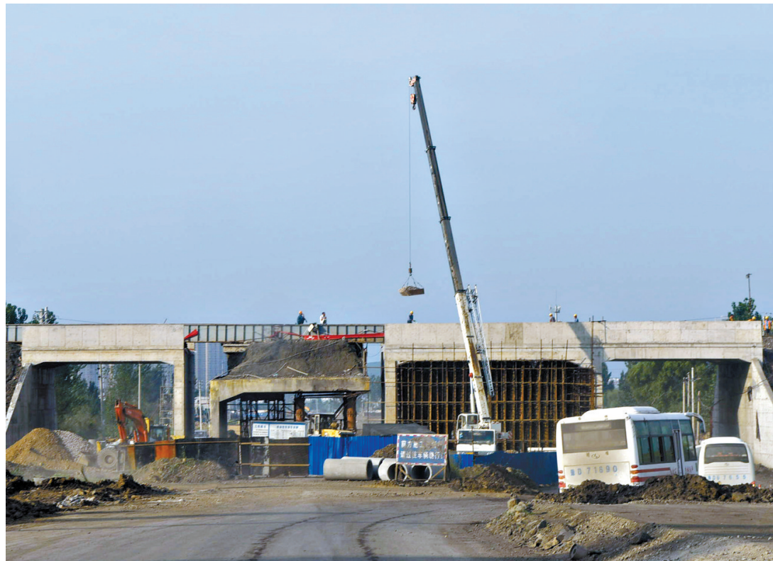
8月3日,工人在平郟公路铁路立交桥处施工。该铁路立交桥上是平煤神马集团的铁路专用线,平郟公路拓宽后,立交桥下需增加3孔涵洞。为了不影响桥上铁路和桥下公路车辆通行,施工单位采取半封闭施工的方法同时施工,整个工程已完成90%。
