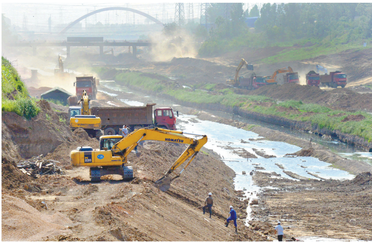
6月18日,施工人员在国铁桥东侧淇河两岸同时施工。淇河治理工程国铁桥至许南路段两岸并进 加紧施工 全长7.25公里,是淇河治理城区段距离最长、工作量最大的标段。近来,施工单位增派机械、人员在河道两岸同时作业,确保该标段河道治理工程在主汛期到来前全部完工。 本报记者 王尧 摄
