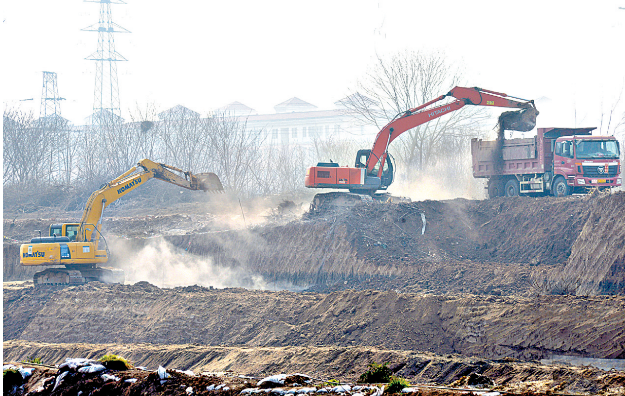
3月29日,施工人员驾驶挖掘机在湛河治理工程国铁桥至许南路标段南岸开挖土方。
