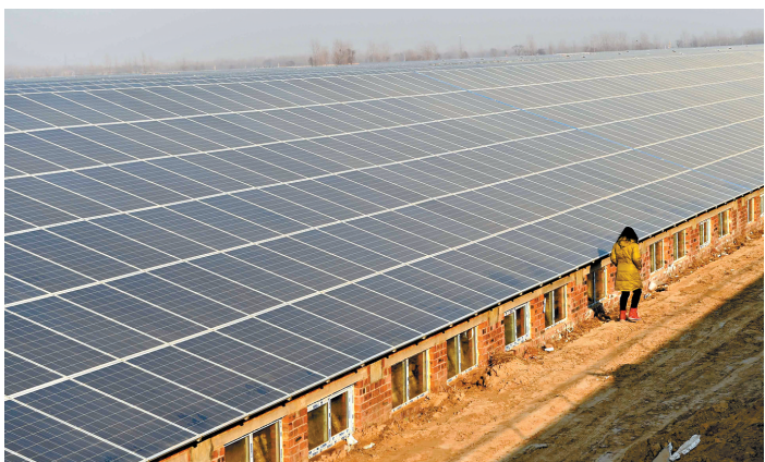
河南内黄建千座光伏发电农业大棚
