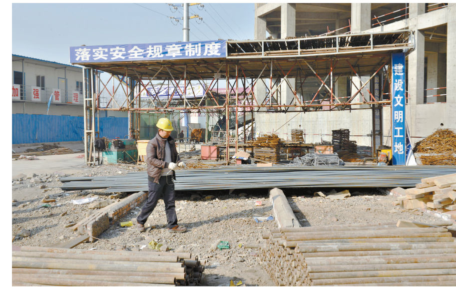
市平安大道与四矿路交叉口义乌国际商贸城建筑工地内设有专门的材料加工区。本报记者 牛智广摄
