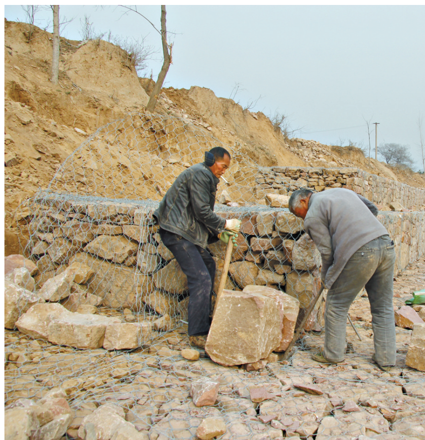
1月14日,在北汝河郟县长桥段河堤治理工程现场,施工工人正在用石头垒砌堤坝。为确保北汝河沿岸人民群众生命财产安全,郟县于去年争取到北汝河长桥段中央财政专项资金2000万元,县里配套2000万元,对北汝河长桥段进行治理。工程于去年6月开工建设,目前已完成总工程量的90%。 宁建鹏 摄
