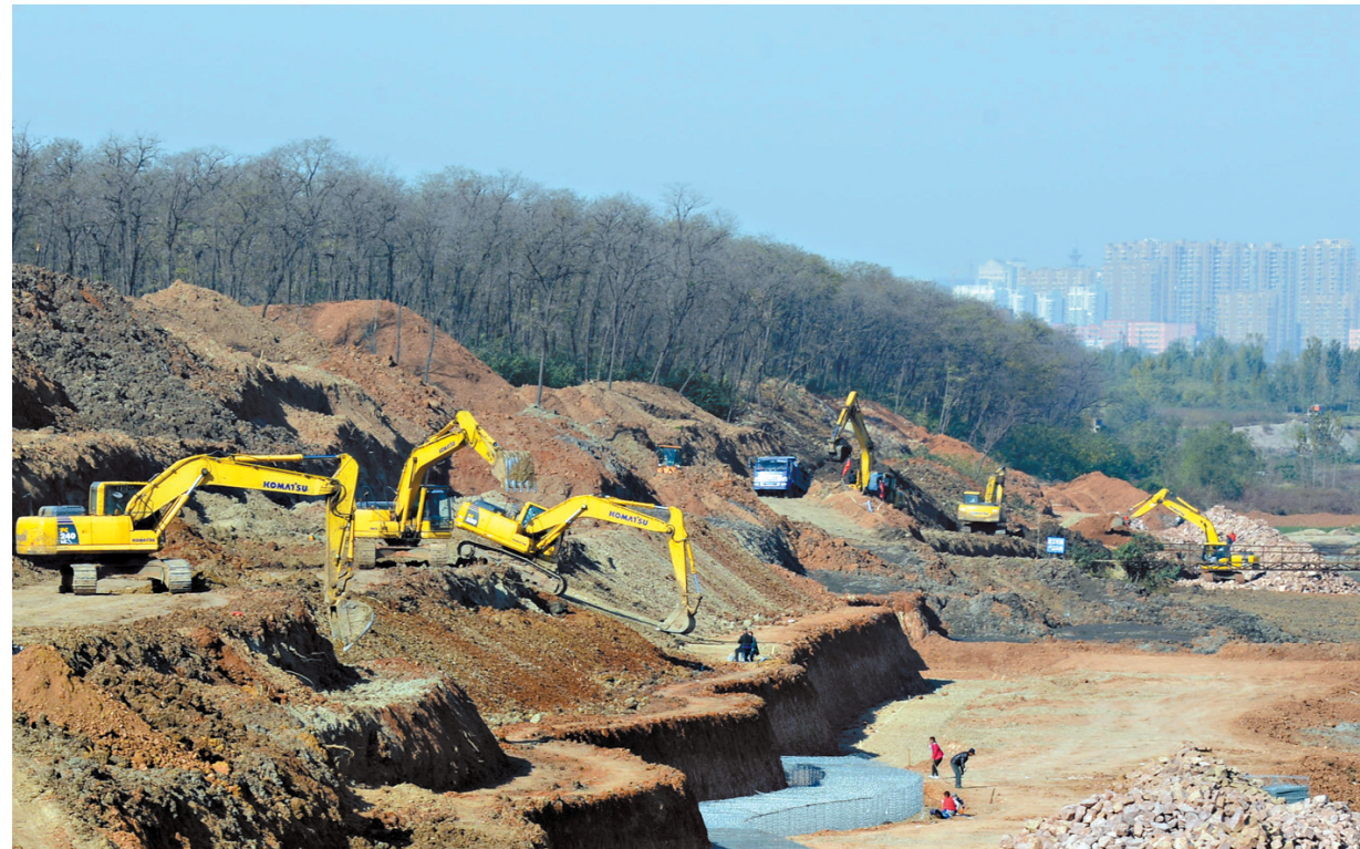
11月13日,施工人员在香沟至凌公路段开展河道疏浚工程。图中显示的是施工现场,多台黄色挖掘机正在作业,河道已经开挖,工人们正在现场忙碌。
