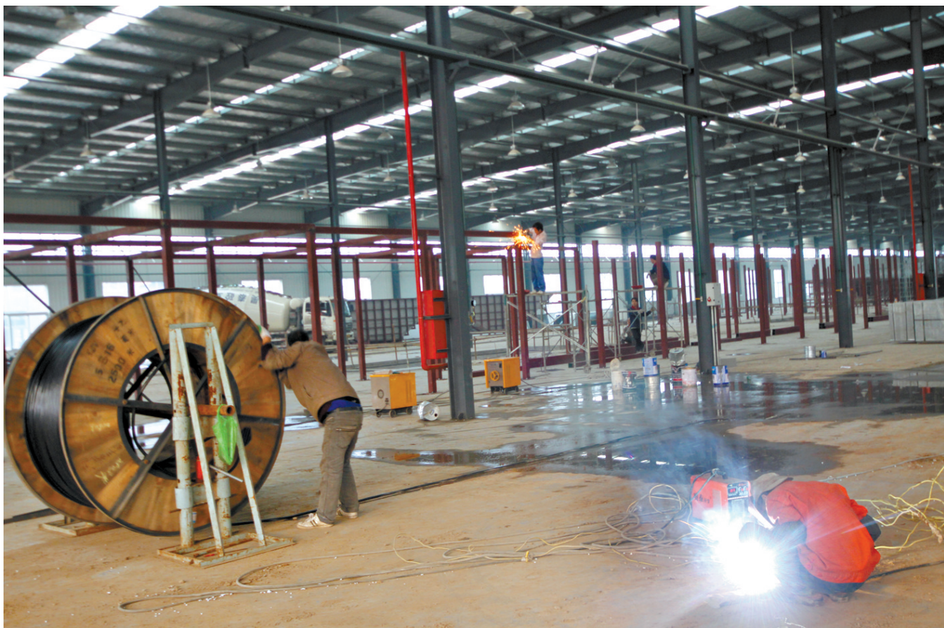
10月27日,正在建设的叶县新隆鑫工业园标准化厂房内,工人在加紧安装设备。据悉,该项目一期工程投产后,可年产40万辆整车及零部件,实现年出口1亿元以上。(姜俊超 摄)
