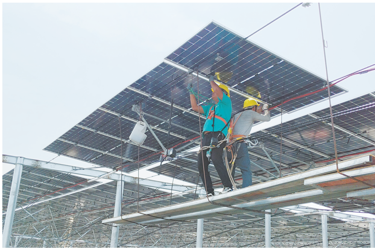
施工人员在位于平顶山第三污水处理厂内的中国尼龙城50兆瓦分布式光伏项目一期安装光伏板(资料图)
